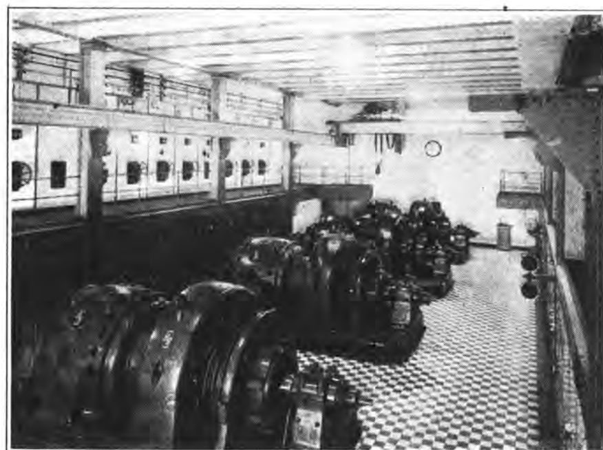
Abb. 2. Umformerwerk Wedding, Maschinenhalle. Kaskadenumformer.
