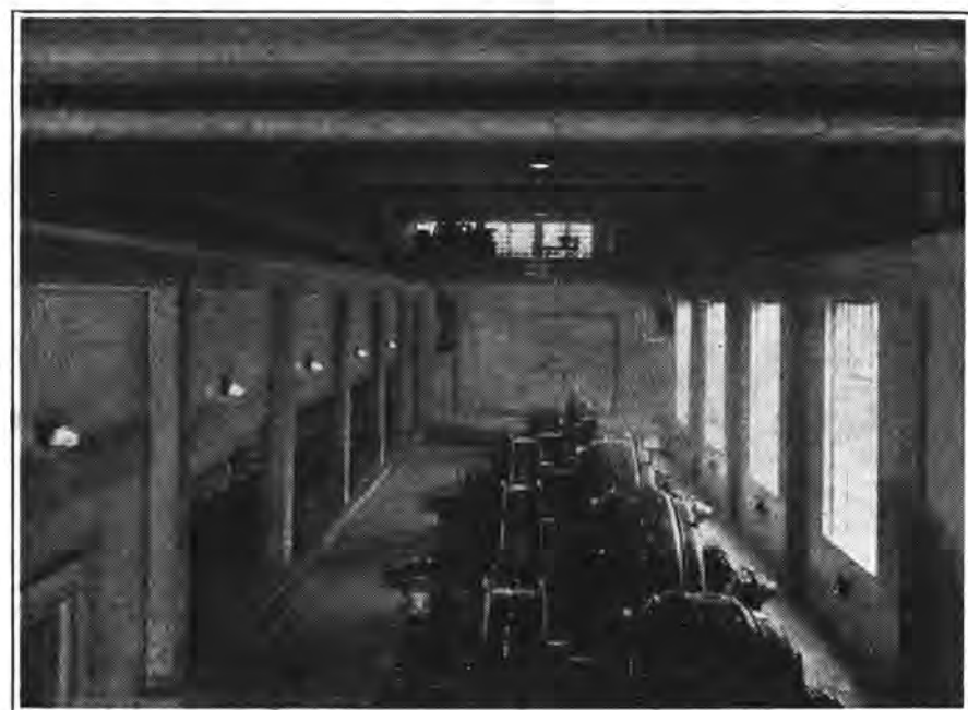
Abb. 1. Umformerwerk Gleisdreieck, Maschinenhalle. Im Vordergrund drei Kaskadenumformer, im Hintergrund zwei Motorengeneratoren.
